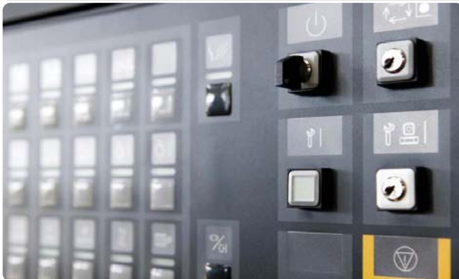
Bild 3: Service auf Knopfdruck: Über einen Taster mit integrierter Status-LED im Bedienfeld der Anlage veranlasst ein Kunde den mGuard Router im Schaltschrank zum Aufbau bzw. Abbau der sicheren Teleservice-Verbindung und hat deren Zustand mit einem Blick unter Kontrolle.
