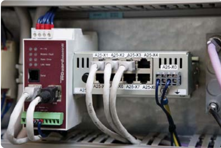
Bild 2: Als sichere VPN-Router verbaut Bihler in seinen Maschinenschaltschränken industrietaugliche mGuard Hutschienen-geräte von Innominate.
